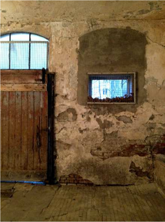
Bild: Hier soll sich schon bald das Auditorium »Room for Improvement« befinden
